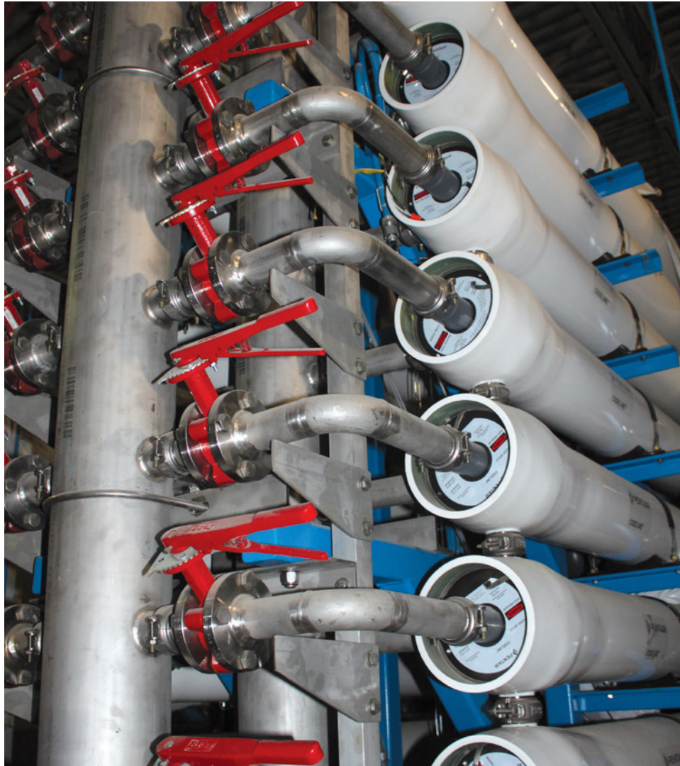
L'un des trois trains de filtration membranaire que l'on retrouve dans le nouveau bâtiment. Composé de gros faisceaux de fibres creuses qui aspirent l'eau à travers de très petits pores, ce nouveau système élimine 100 % des particules ou bactéries indésirables.
