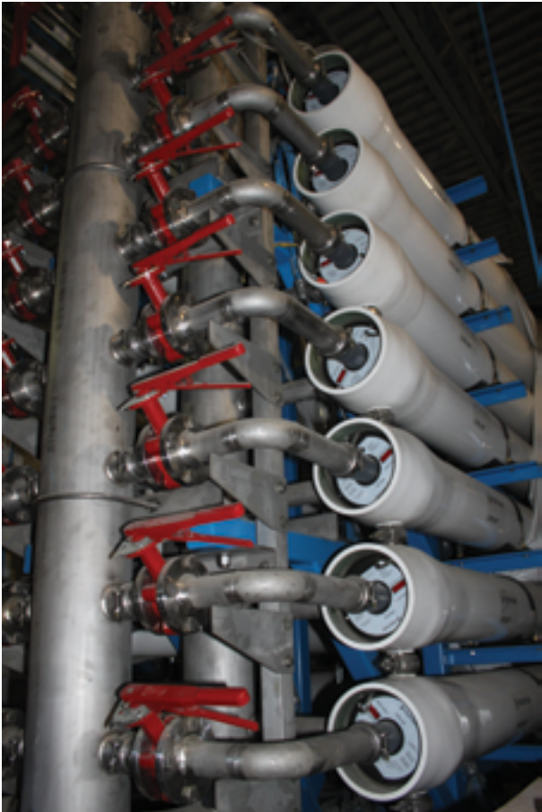
Train de filtration membranaire
